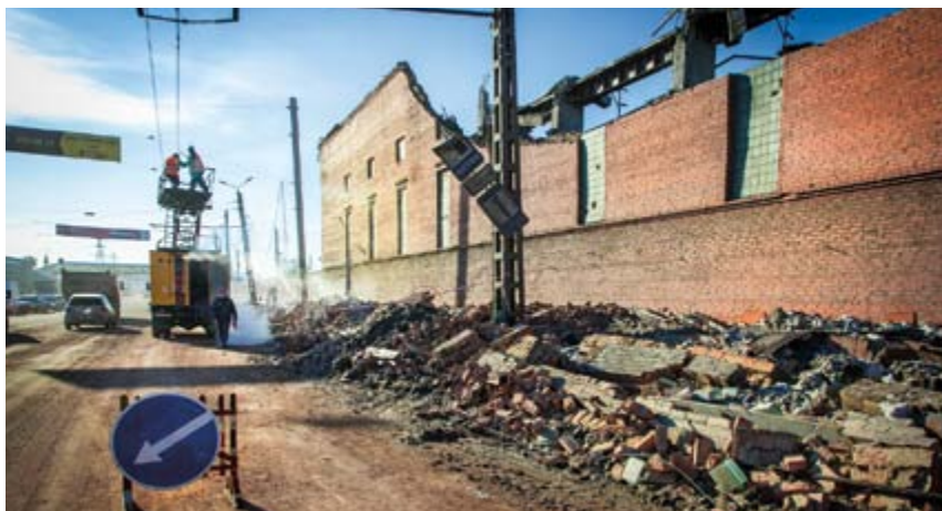
Daños causados por el bólido de Cheliábinsk el pasado mes de febrero.
